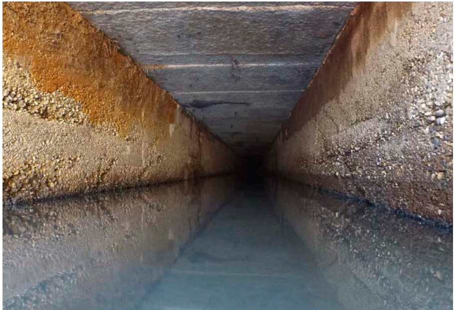
De betonnen overkluizing van de Maasnielderbeek bleek danig aangetast.
