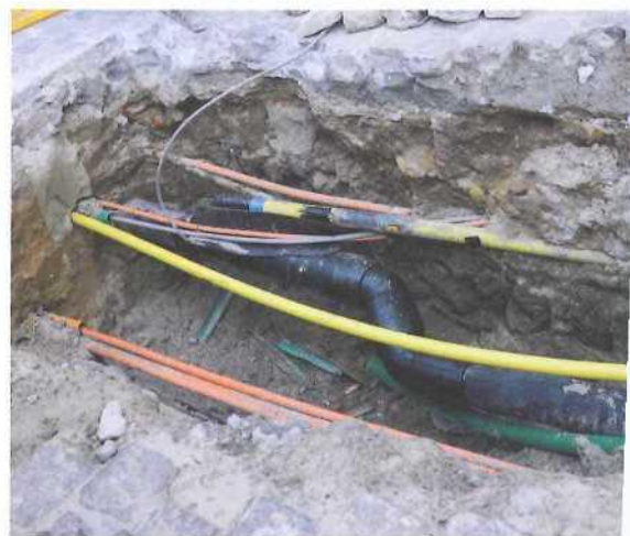
Onder de grond is het vaak een wirwar van kabels en leidingen.
